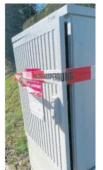
Der Verteilerkasten an der Klagebach wurde am Wochenende von der Polizei abgesichert. FOTO: MEYER
